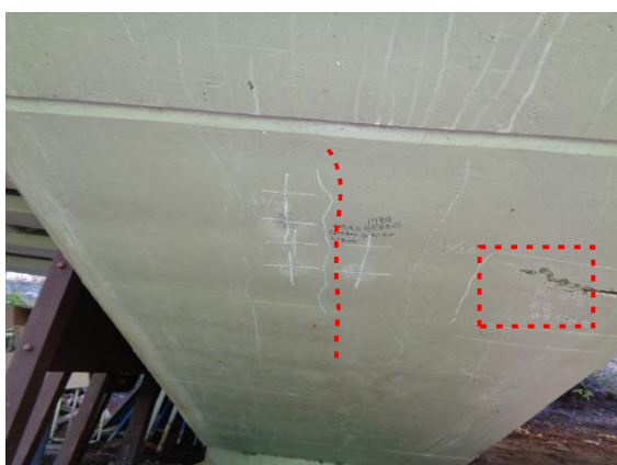
균열, 박리 및 박락 (0.4mm) (P1-코핑부)
